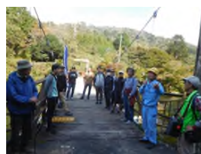
東北電力第二発電所
